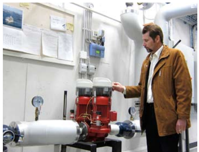
Pauli Salonen esittelee lämpökeskuksen laitteistoa, jonka kehitykseen hän on aktiivisesti osallistunut. Kuvan kaksi punaista pumppua kierrättävät lämmitetyn veden 130 huoneiston tarpeisiin. Pauli kertoo, että hän on kiinnittänyt erityistä huomiota putkiston lämpöhäviöiden minimointiin ja lisäeristänyt verkoston Lecasoralla.
