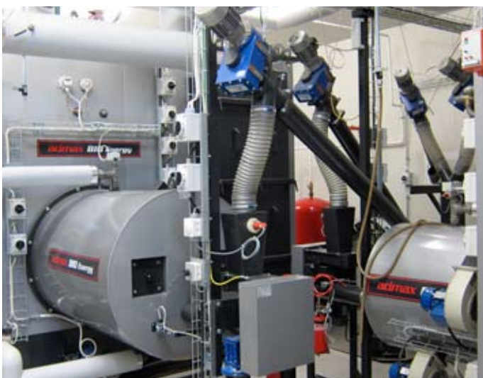
Aluelämpökeskuksessa lämpöä tuottavat rinnakkain Aritermin 700 kW ja 300 kW kattilat. Neljä kuljetinta siirtää pelletit ulkona olevista kahdesta siilosta laitteistoihin. Lämpökeskus on siisti ja valoisa. Sen yhteydessä on myös sosiaali- ja kokoustilat.
